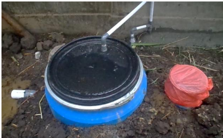
Gambar 2.3 Instalasi Produksi Biogas Sederhana
